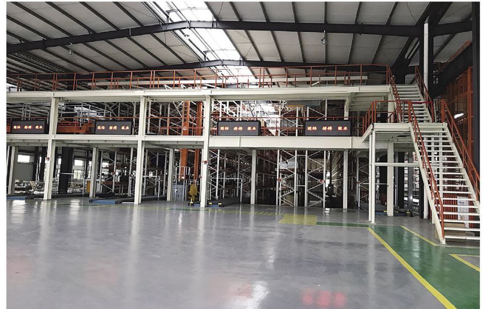
广东温氏集团新兴南牧机械有限公司仓库货架由大昌公司承建
